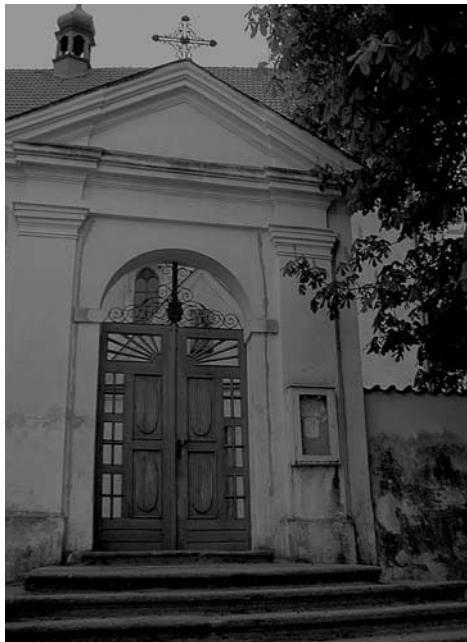
Stav brány a zdi před opravou
