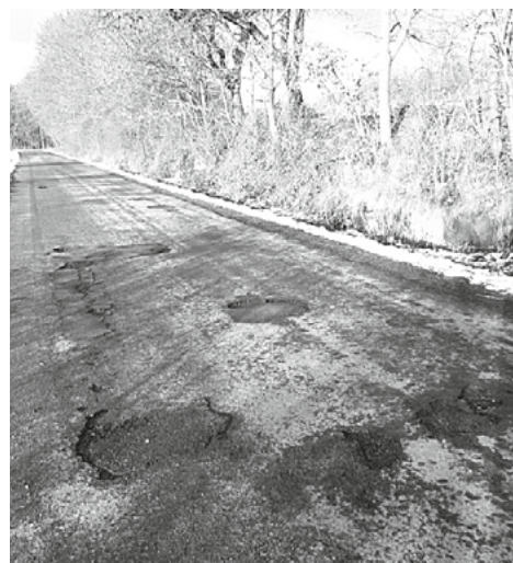
Stav komunikace Vozerovice-Bolechovice letos v zimě
