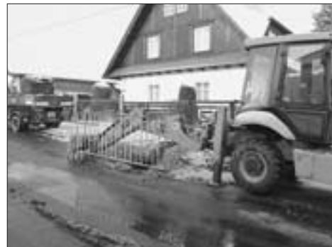
Místo poruchy na vodovodu, oprava se protáhla až do nočních hodin
