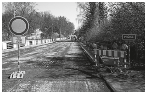
10. 4. – krátce po převzetí stavby zmizel asfalt
