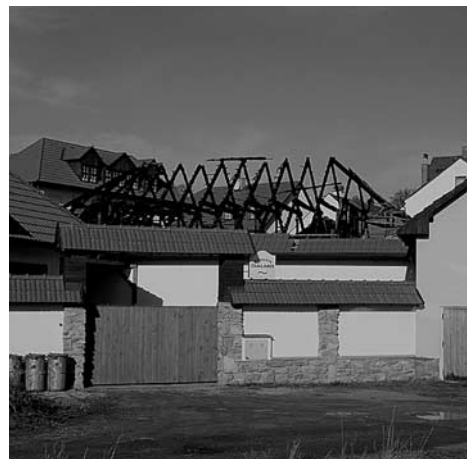
V noci 2. listopadu hořel objekt penzionu Dalmo v Sedlci.
