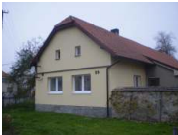
NEVHODNÉ TVAROVÁNÍ PŘI ZATEPLENÍ FASÁDY
