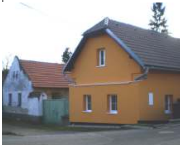
NEVHODNÁ POLOHA ŘÍMSY VE ŠTÍTU PO ZATEPLENÍ
