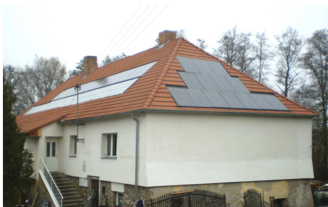
NEVHODNĚ UMÍSTĚNÉ PANELE NA VALBOVÉ STŘEŠE PAMÁTKOVĚ CENNÉHO DOMU
