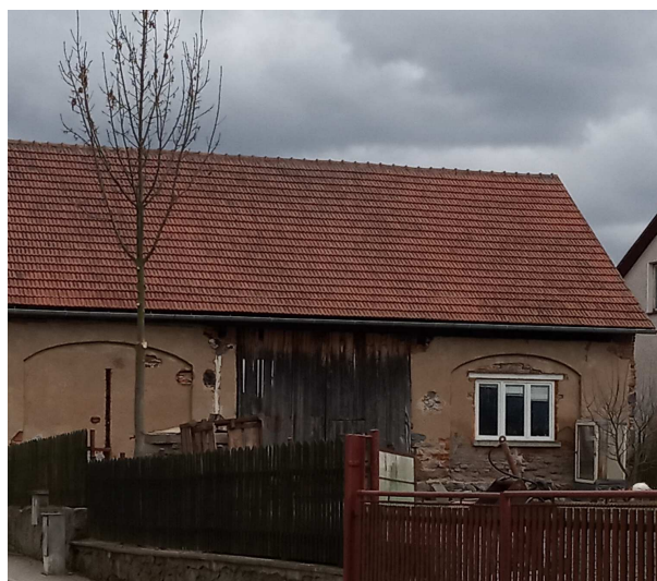
NEVHODNÝ TVAR A ČLENĚNÍ OKNA STODOLY
