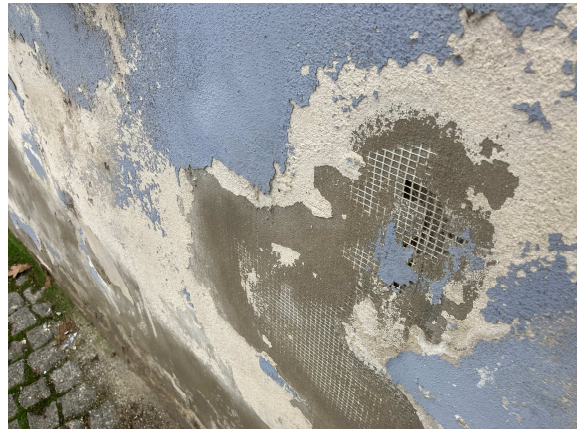
A DEGRADACE TVRDÉ OMÍTKY S PERLINKOU
