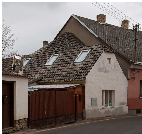
STŘEŠNÍ OKNO PŘÍLIŠ BLÍZKO ŠTÍTU
