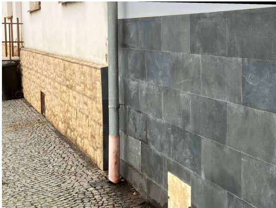
MATERIÁLOVĚ NEVHODNÝ OBKLAD SOKLU
