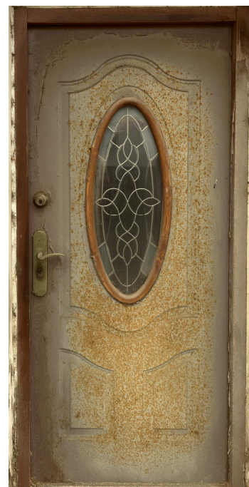
DEGRADACE PLASTOVÝCH DVEŘÍ
